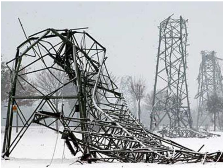
Münsterland 2005 – Mastenbruch durch Schneelast - Foto: Netze BW GmbH/WDR
